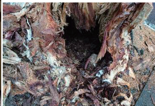
中空腐朽樟樹預防性移除
