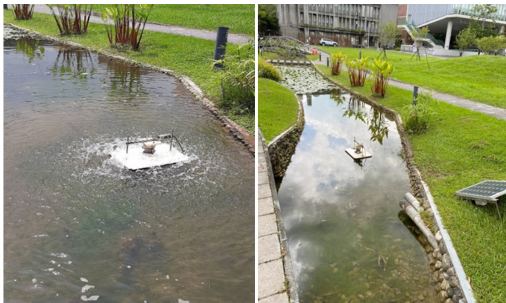
瑠公圳醉月湖段太陽能曝氣設備
