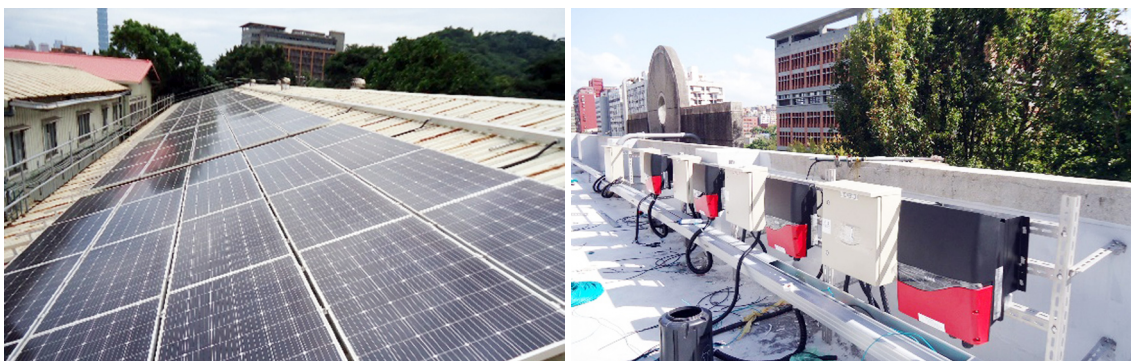
太陽能板及電力設備
