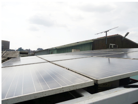
工綜館實驗用設置太陽能發電設備
