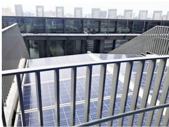
次震宇宙館設置太陽能發電設備
