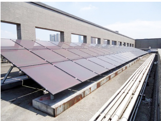
博理館廠商捐贈設置太陽能發電設備
