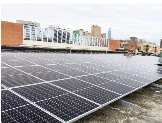
普通教學館設置太陽能發電設備
