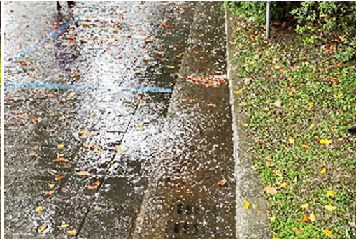
雨天行政大樓周圍水溝孔蓋覆蓋積水
