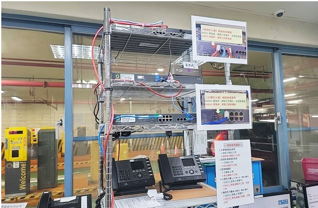
車牌辨識系統網路防火牆照片
