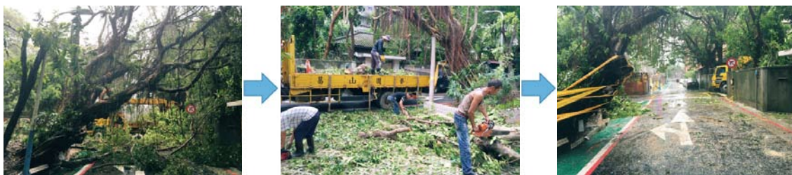
青田街 7 巷 7 號前榕樹樹體傾倒壓路緊急鋸除復原
