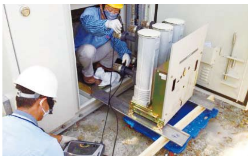
高壓設備停電保養測試
