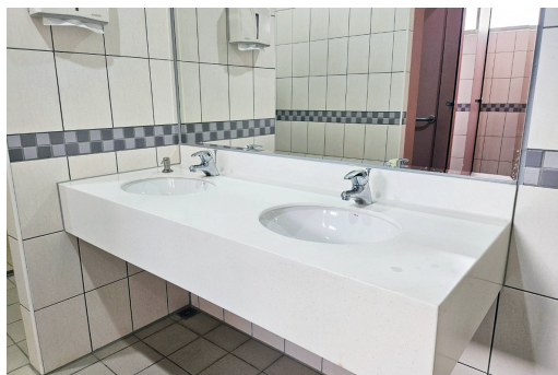
廁所汰換水槽式按壓洗手乳機
