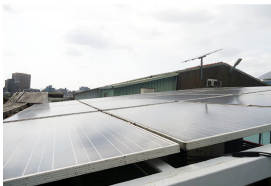
工綜館實驗用設置太陽能發電設備
