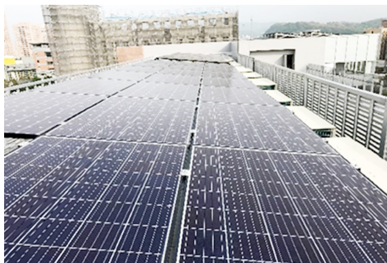
鄭江樓廠商捐贈設置太陽能發電設備
