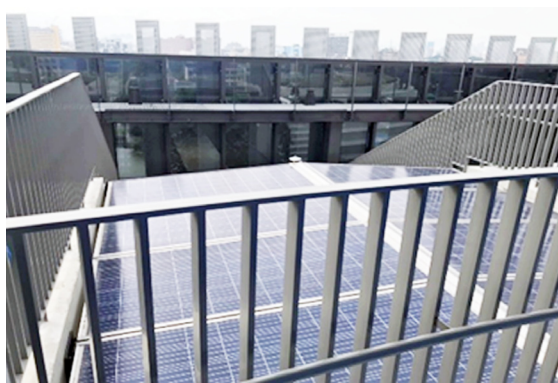
次震宇宙館設置太陽能發電設備
