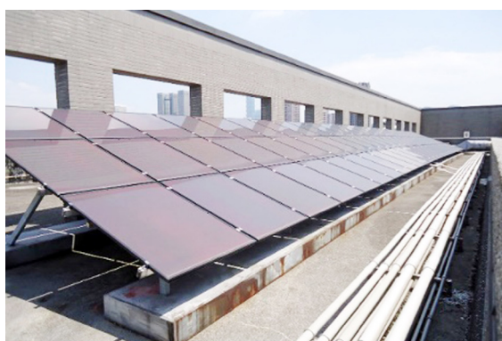
博理館廠商捐贈設置太陽能發電設備
