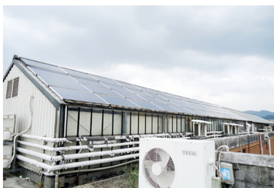
農綜館廠商捐贈設置太陽能發電設備
