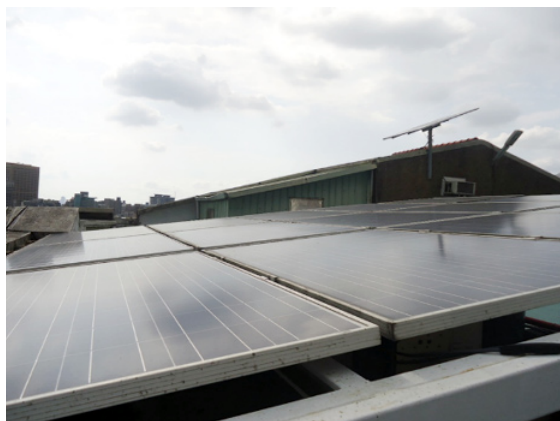
工綜館實驗用設置太陽能發電設備
