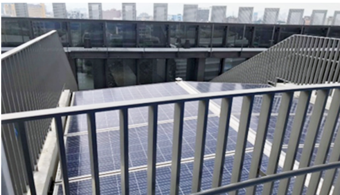
次震宇宙館設置太陽能發電設備
