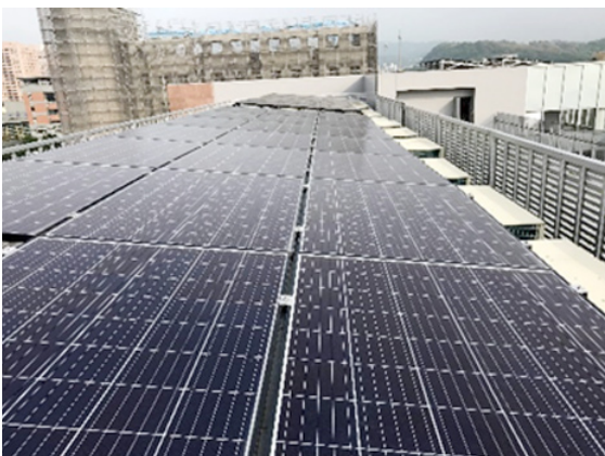
鄭江樓廠商捐贈設置太陽能發電設備
