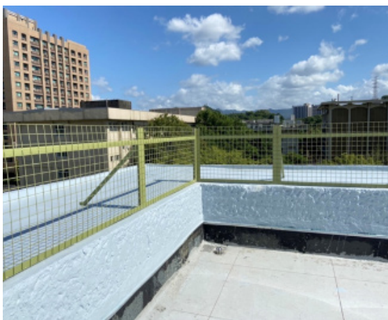
女兒牆防墜欄杆
