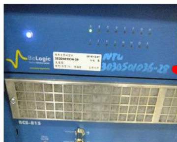
模組式電池充放電設備-財產貼牌
